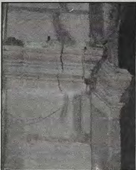
Existe desmoronamiento en las cornisas de la nave del templo.
