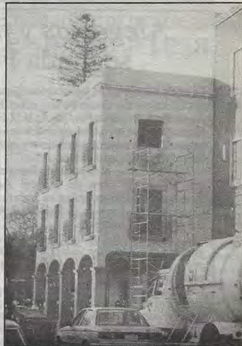
Las ventanas del inmueble de la Unidad Cultural del Centro están siendo tapiadas.
