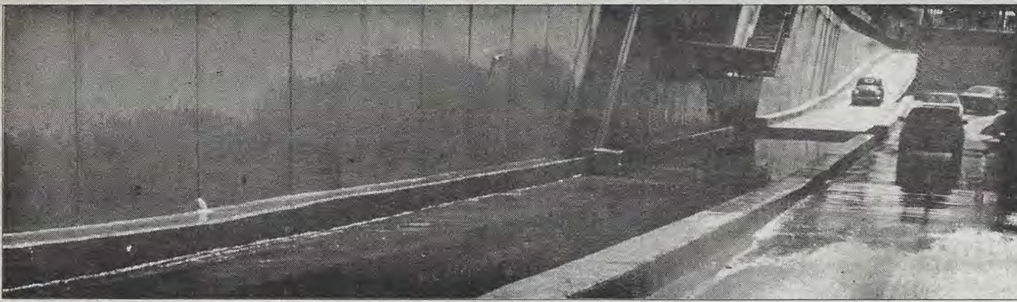
Borbotones de aguas negras brotan de entre el muro del paso a desnivel de Felipe Angeles. ¿Será necesario tirar el muro para hacer la reparación?
