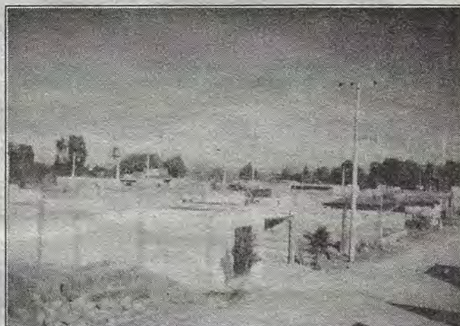
En Manantiales de San Juan, existe el 91.5% de avance en la construcción de casas.
