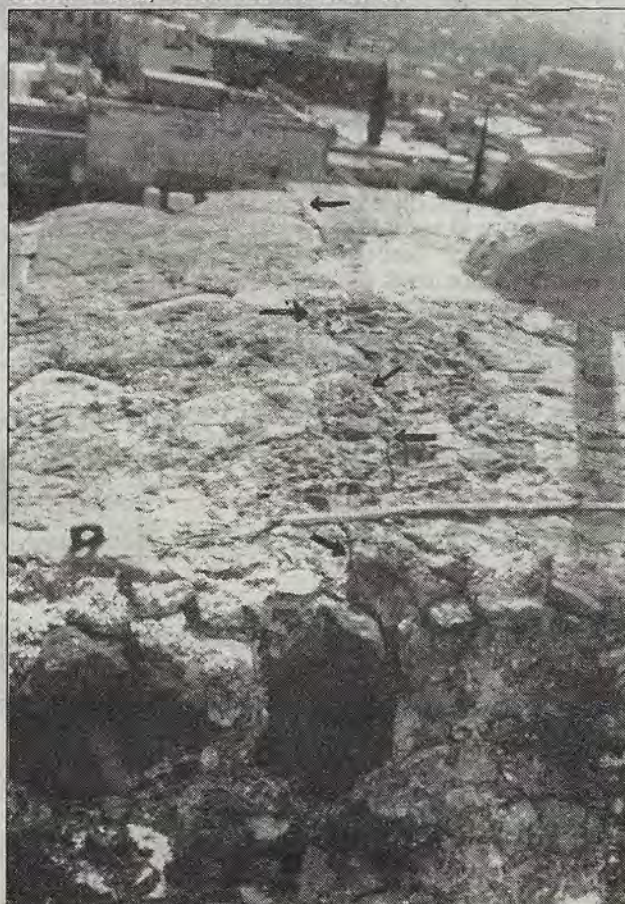
Junto al asta-bandera, en el remate de la fachada, la línea de la grieta.
