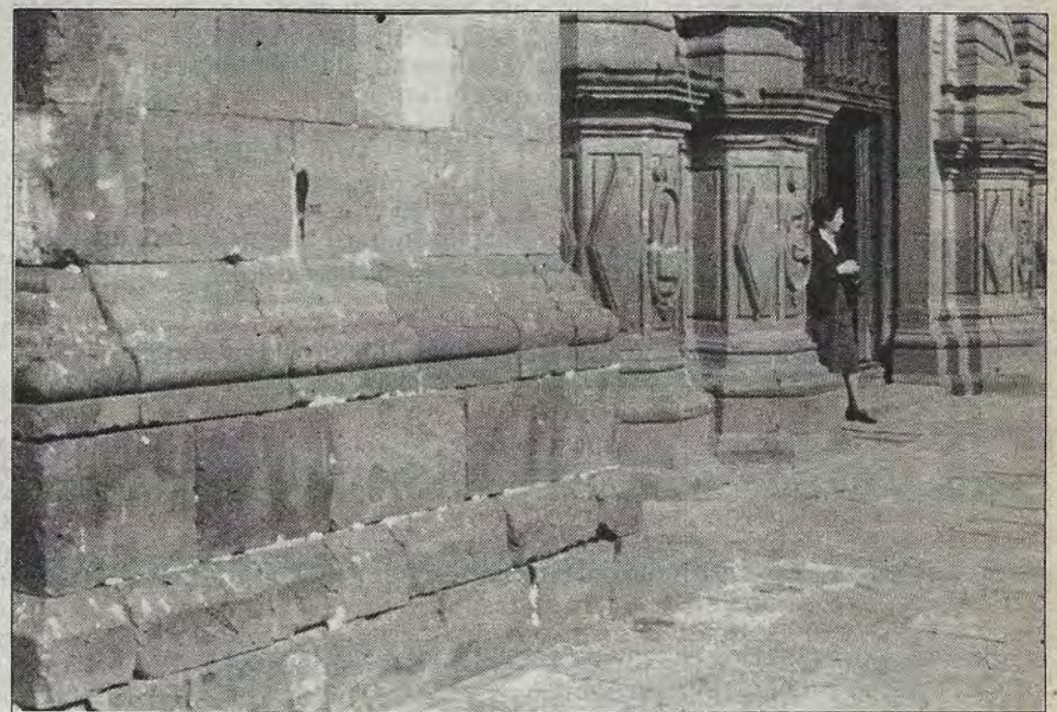
Las juntas, desprendidas.
