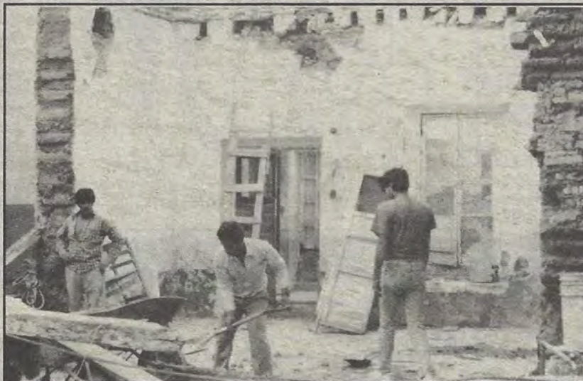
La semana pasada se derrumbó uno de los muros interiores de la escuela Miguel Hidalgo, en Arteaga, a un costado de la Plazuela Mariano de las Casas. Afortunadamente ningún alumno fue lesionado, pues el derrumbe ocurrió durante el recreo. (Foto de Omar Ontiveros)
